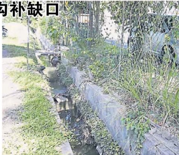
水流从沟渠溢出后冲向 28/2 路的住家。
